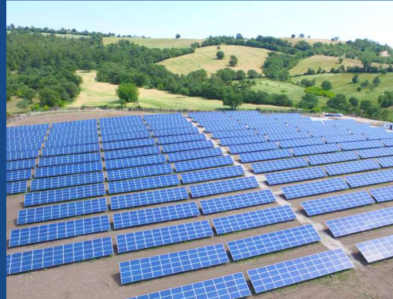
1 MW GES PROJESİ GES PROJESİ ÇANAKKALE
